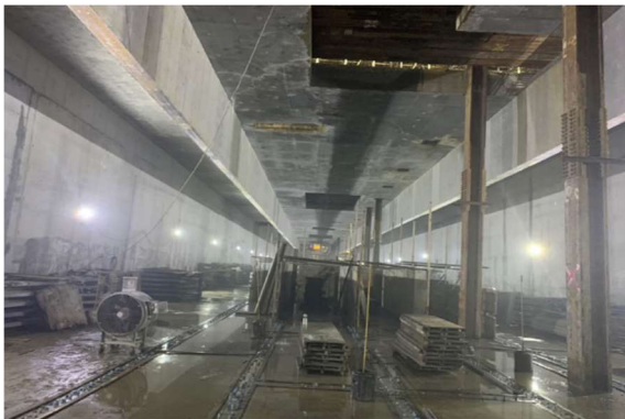
(照片 3) 信義線東延段工程 R03 站 軌道層月台模板施工現況
