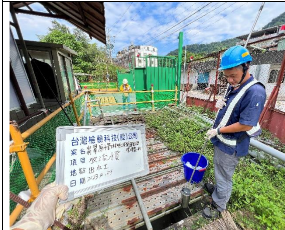
工區放流水(出水工)
