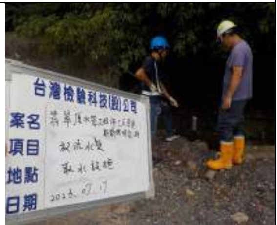
工區放流水(取水設施)
