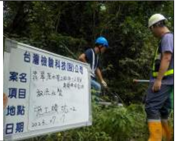
工區放流水(2號施工橫坑)
