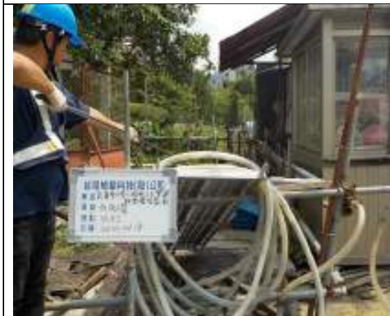
工區放流水(出水工)
