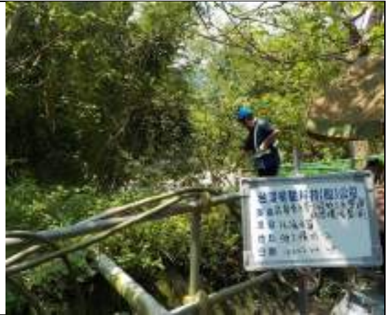
工區放流水(2號施工橫坑)
