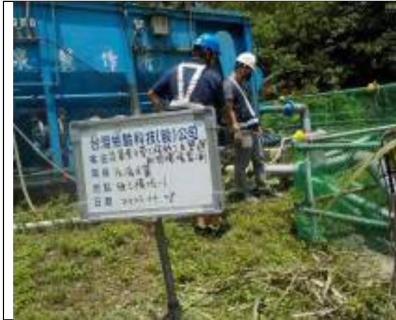
工區放流水(1號施工橫坑)
