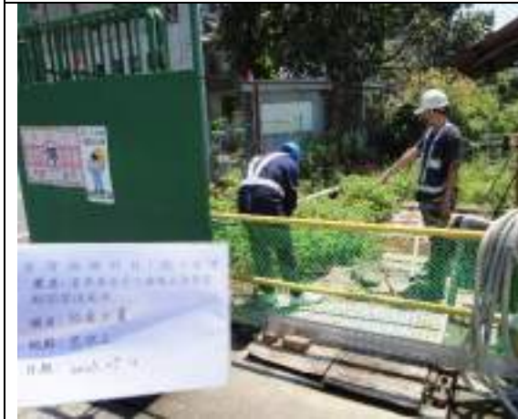
工區放流水(出水工)
