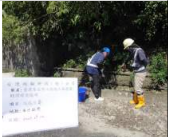
工區放流水(取水設施)
