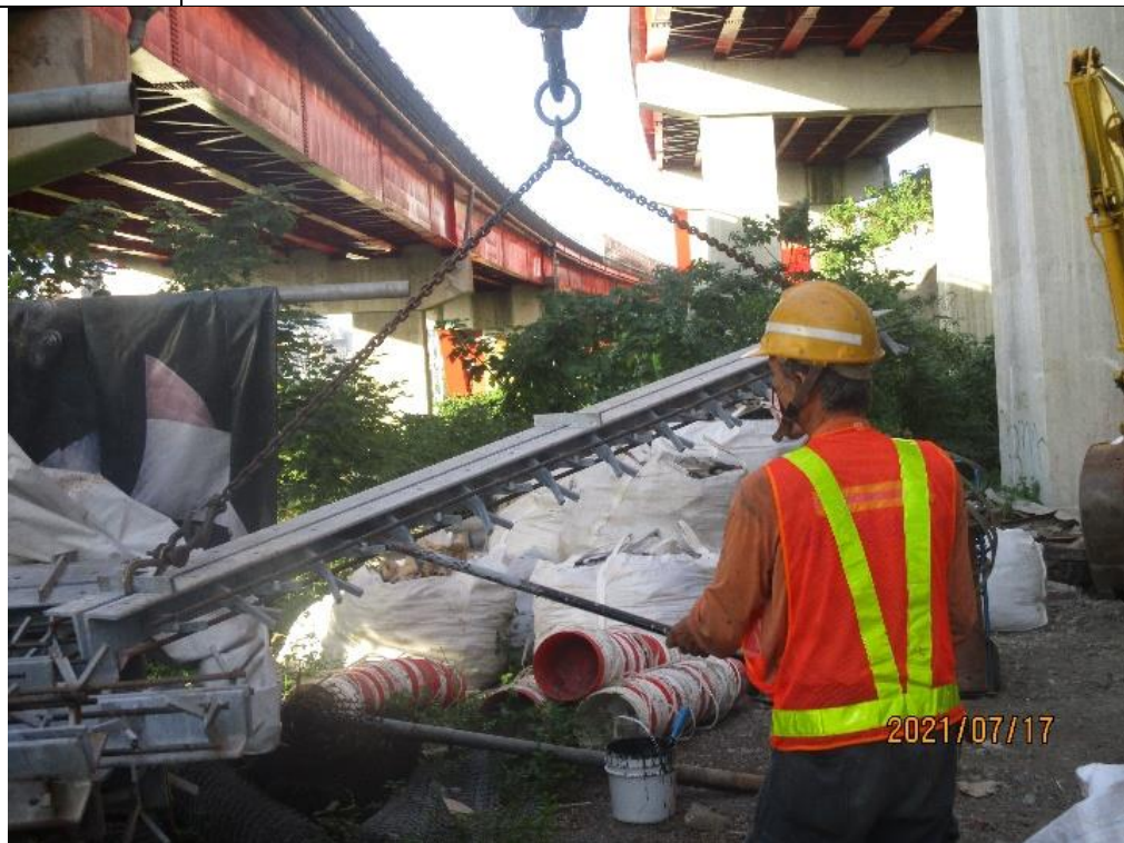
說明二 荷物起吊離地後，不得以手碰觸荷物，並應確認吊運路線，警示、清空擅入吊運路線範圍內之無關人員。
