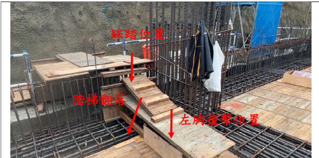
說明一 事發現場勞工踩踏之階梯。
