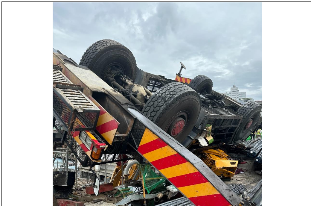
說明 移動式起重機翻車
