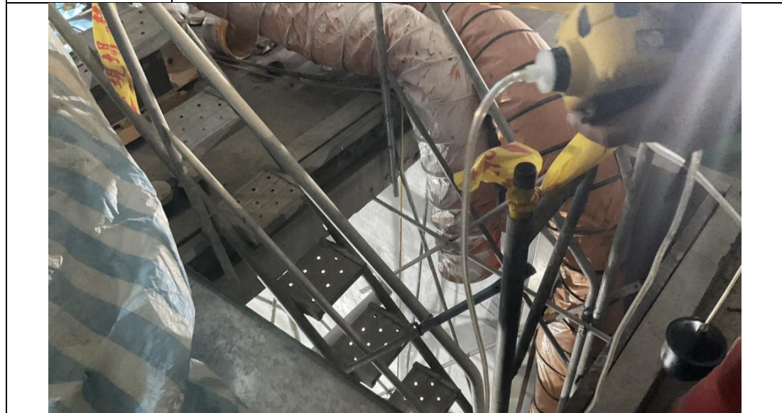
說 明 池槽 (局限空間作業) 入口。
