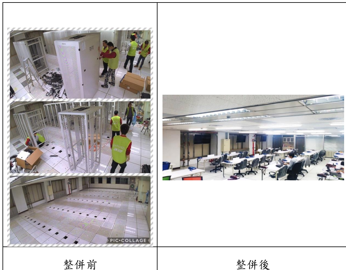
圖 17：市政大樓 10 樓東南區主機房已完成整併 於世大運期間供技術運行中心使用
