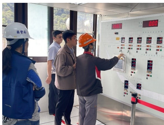
大壩水工閘門操作系統測試
