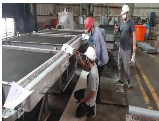
翡翠發電機組空氣冷卻器購置
