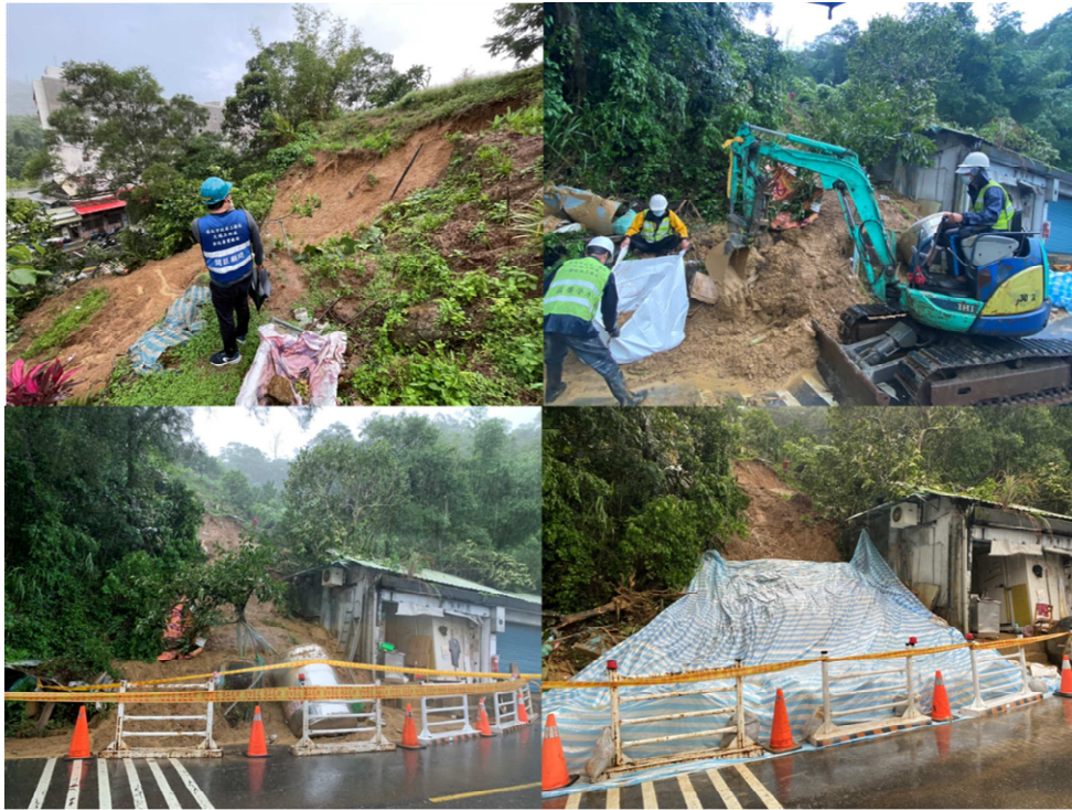
說明:文山區萬壽路邊坡緊急處理
