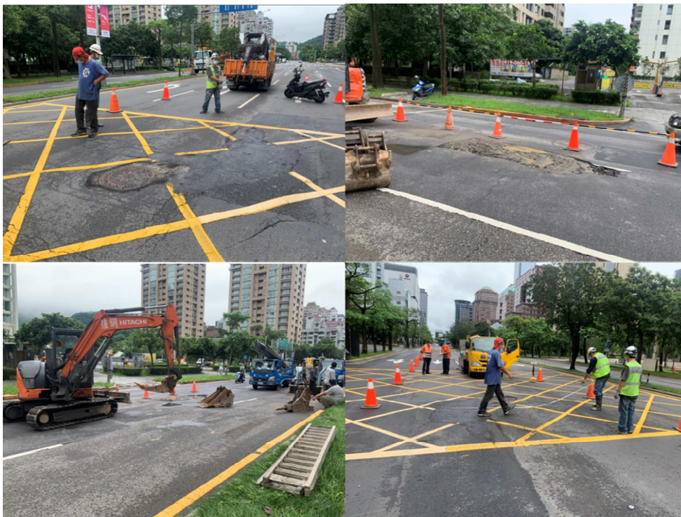
說明:信義區松仁路路面破損處理
