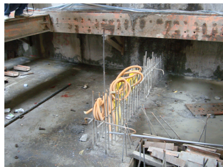
說明：勞工墜落後遭鋼筋刺入腿部。
