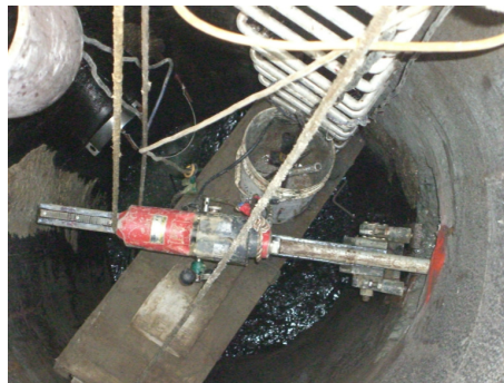
說明：事故現場之洗孔機。
