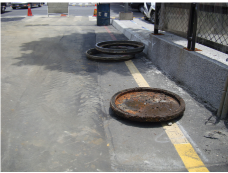
說明：現場人孔蓋情形。
