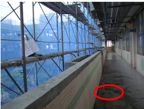
說明：勞工墜落處。
