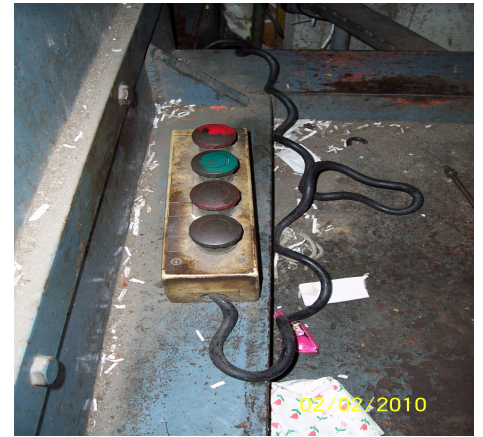
說明：緊急制動裝置未在操作位置附近。
