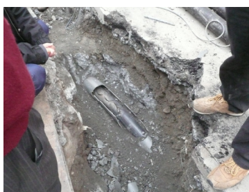
說明：電纜破損情形。
