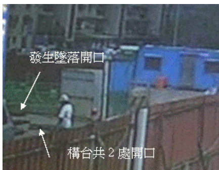
說明：勞工由施工構台開口墜落。
