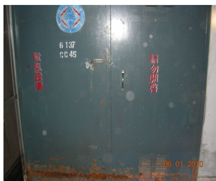
說明：台電受電室鐵門未上鎖。
