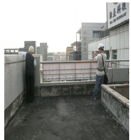
說明：罹災者高處作業處。
