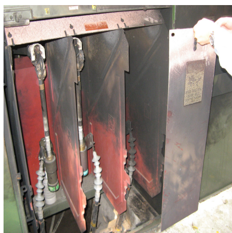
說明：前遮板拆卸後匯流排焦化情形。
