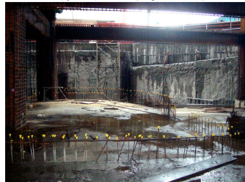
說明：工地預留鋼筋應採彎曲尖端護套等防護設施。
