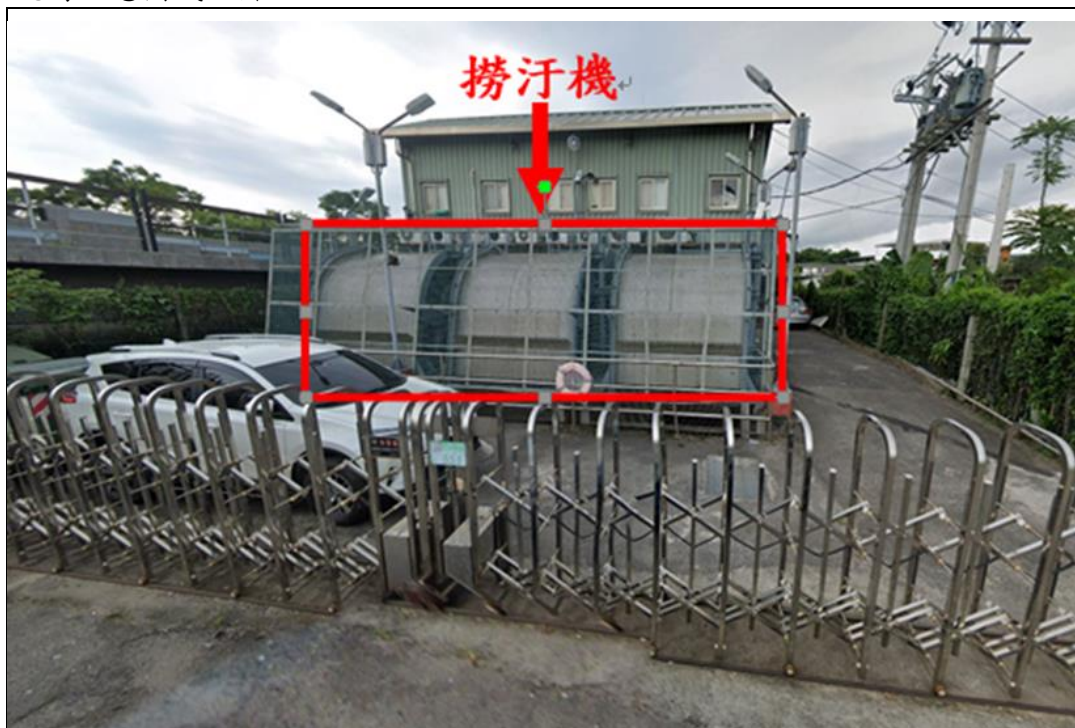
說明一 抽水站撈汙機。
