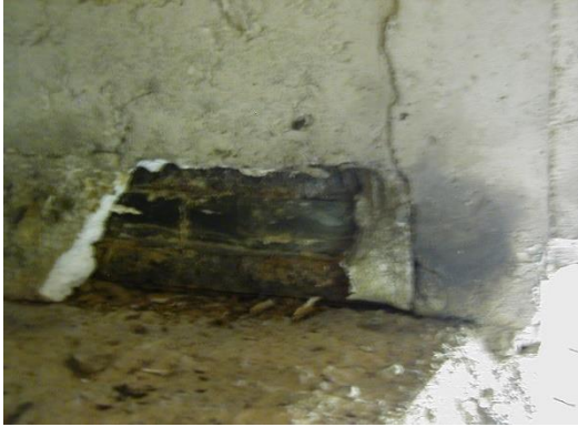
15. 支承墊 (橡膠硬化)
