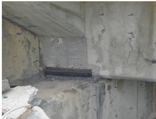
15. 支承墊 18. 主構件 (端有剪力裂縫)
