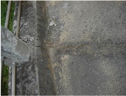
17. 伸縮縫 (擠壓破壞)
