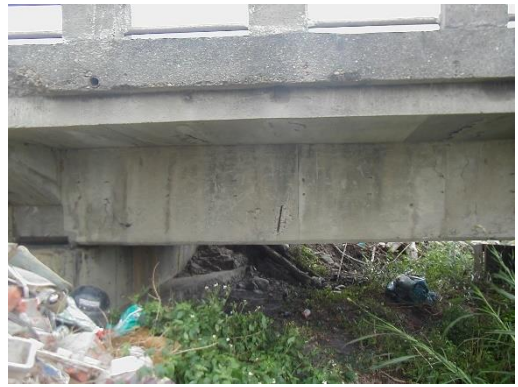
18. 主構件-3 (支承端有剪力裂縫)
