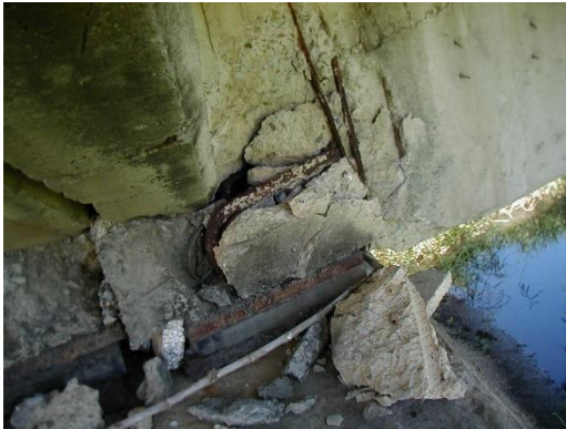
18. 主構件-2 (承壓破壞)
