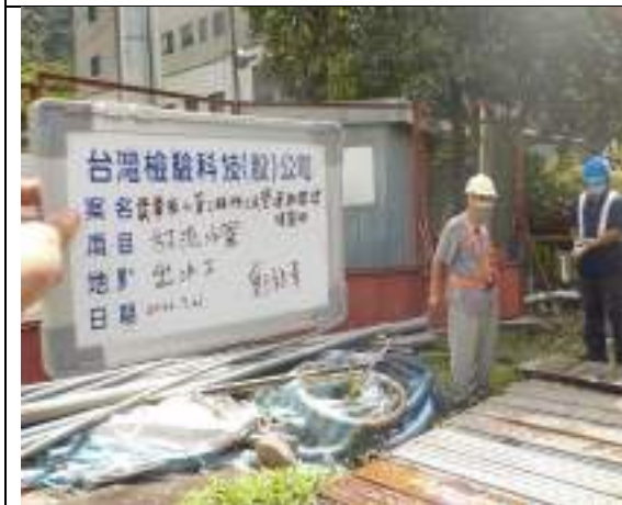
工區放流水(出水工)
