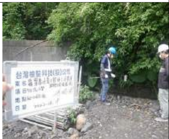
工區放流水(取水設施)
