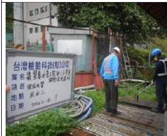
工區放流水(出水工)
