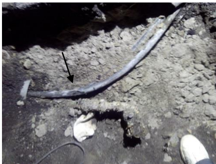
說明：遭受誤擊之高壓電纜及欲搶修之漏氣瓦斯管。 （照片由瓦斯公司提供）
