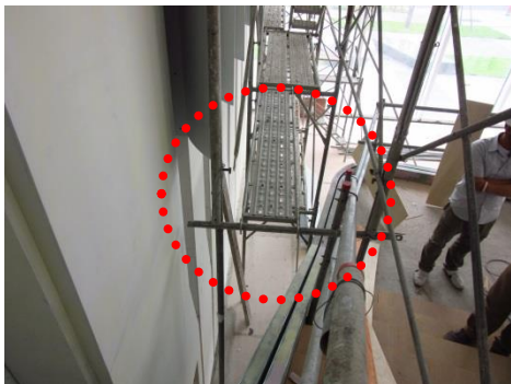
說明：勞工許○從施工架側邊開口墜落至1樓地面。（高度約3.2公尺）。
