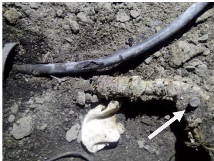
說明：漏氣瓦斯管上有木塞止漏。 （照片由瓦斯公司提供）
