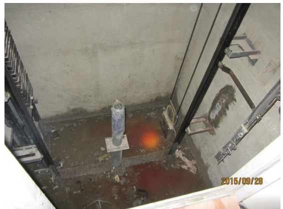
說明：自1樓墜落至地下4樓機坑。
