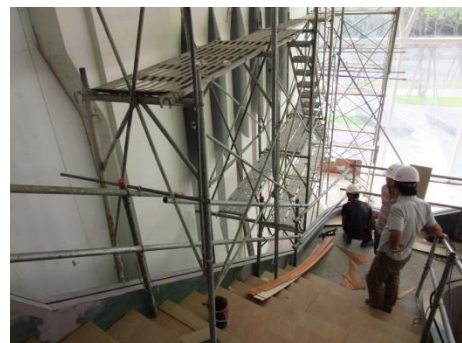
說明：施工架開口應確實施作護欄等防護設施。
