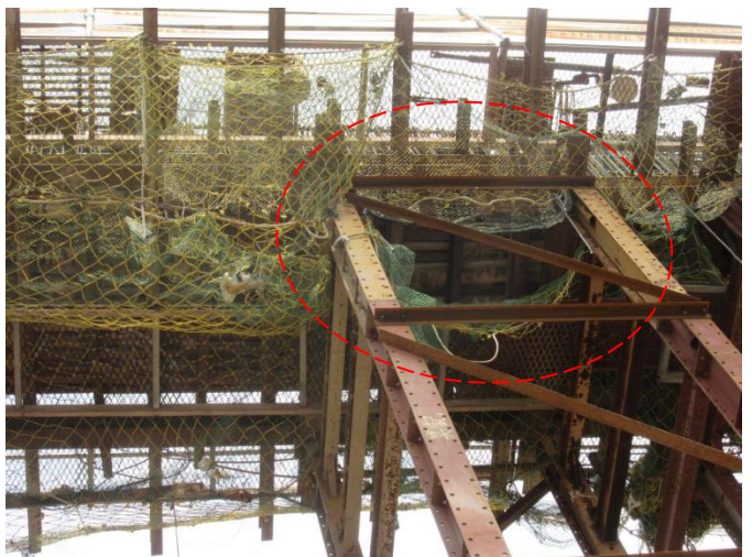
說明：罹災勞工撞破安全網後墜落至地面。
