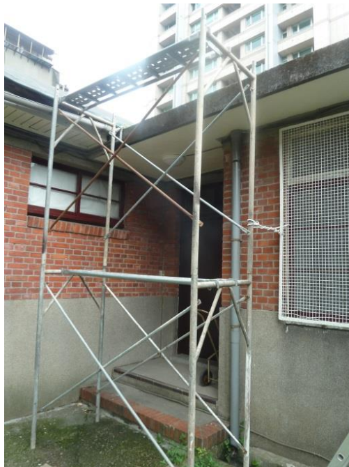
說明：移動式施工架未設置防墜及上下設備。
