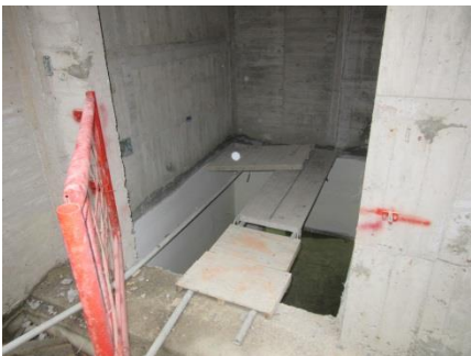
說明：說明：一樓機械坑施工平臺開口未設防墜設備。
