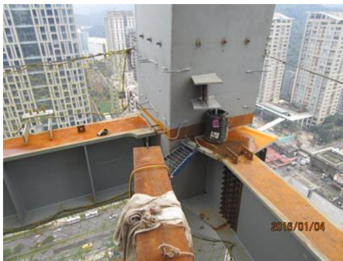
說明：現場鋼樑倒落情形。
