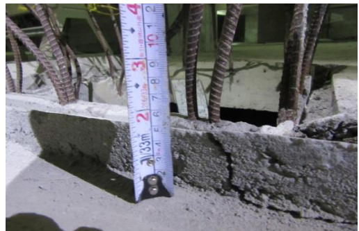
說明：水箱孔四周之防水墩座，未保持不致使勞工跌倒、滑倒等之安全狀態，或採必要之預防措施。
