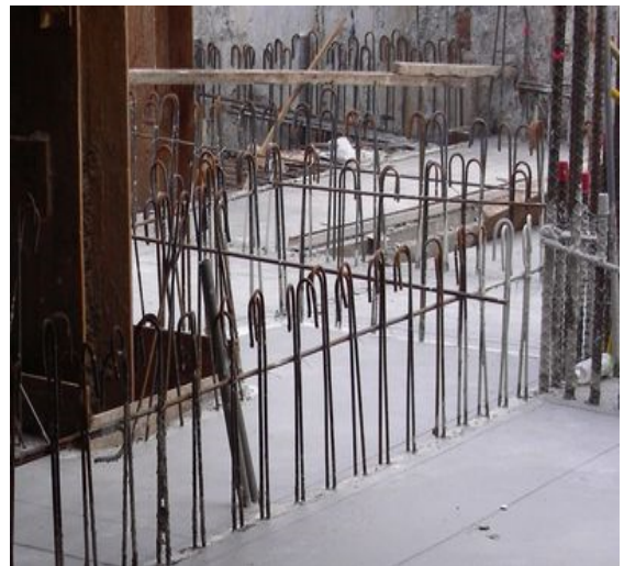
說明：工作場所暴露之鋼筋應採取彎曲尖端、加蓋或加裝護套等防護設施。
