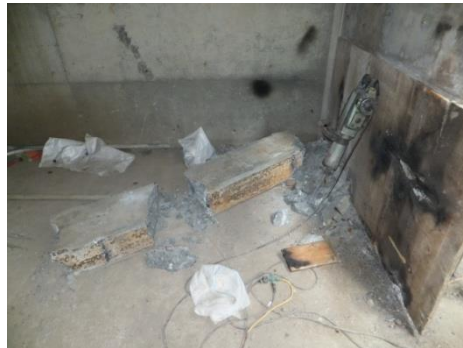
說明：混凝土柱塊受打除震動 傾倒斷成二截
