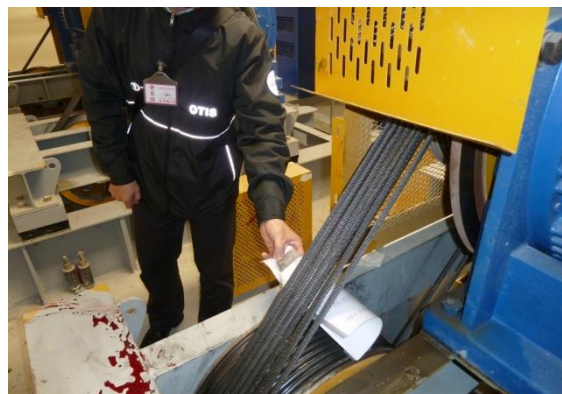
說明:受災者清洗鋼索作業，左手前
