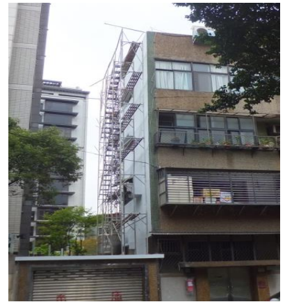
說明：施工架未設置中欄杆， 水平踏板未滿鋪。
