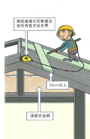
說明：屋頂作業應設置防止勞工踏穿墜落之設施，且使勞工確實使用安全帶、安全帽及其他必要之防護具。
