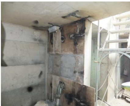
說明：災害現場(共同管道內)
