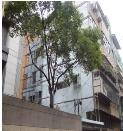
說明：罹災者由2樓施工架踩空墜落 工架踩空墜落
