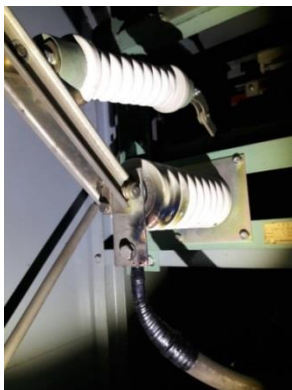
說明：配電箱內隔離開關上留有高壓電燒黑痕跡。
