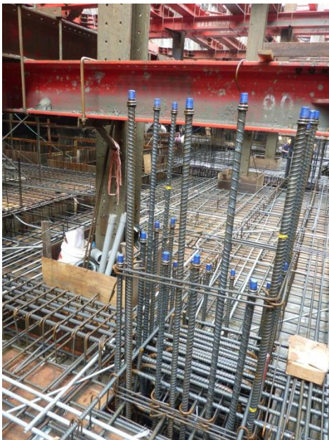
說明：勞工墜落之安全支撐型鋼。
