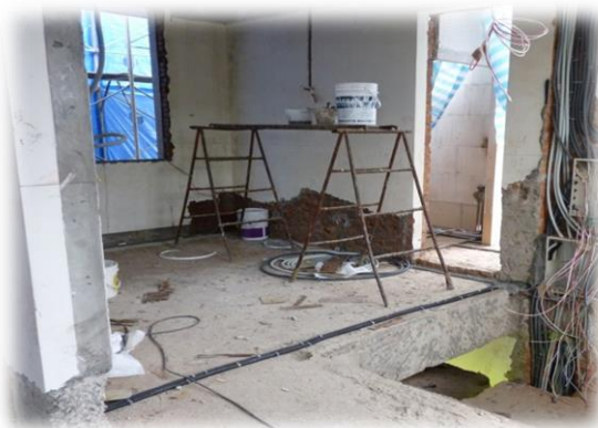
說明：勞工作業區域位於樓梯開口旁。
