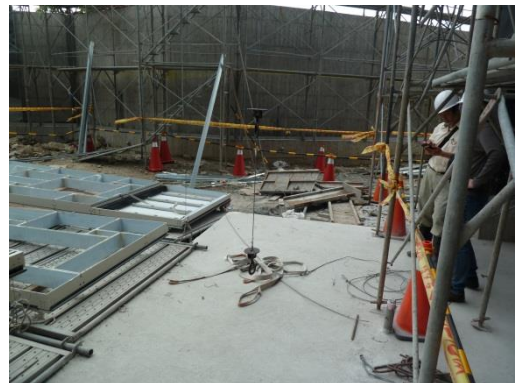
說明：現場物體飛落情形。
