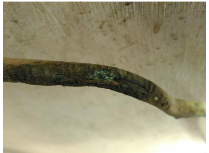
說明：現場電線裸露引起火花。
