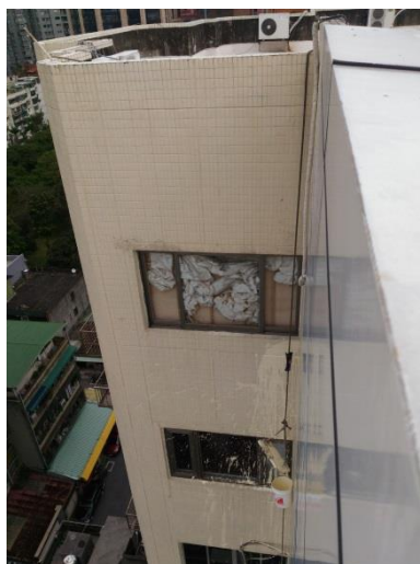
說明：作業勞工墜落現場及現場情形。
