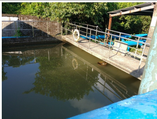
廢水池(未回收直接溢流)
