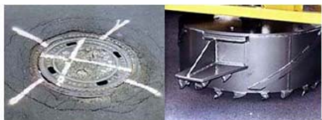
圖 2-11 將破損之人孔蓋進行切割(費時 1-3 分鐘)
