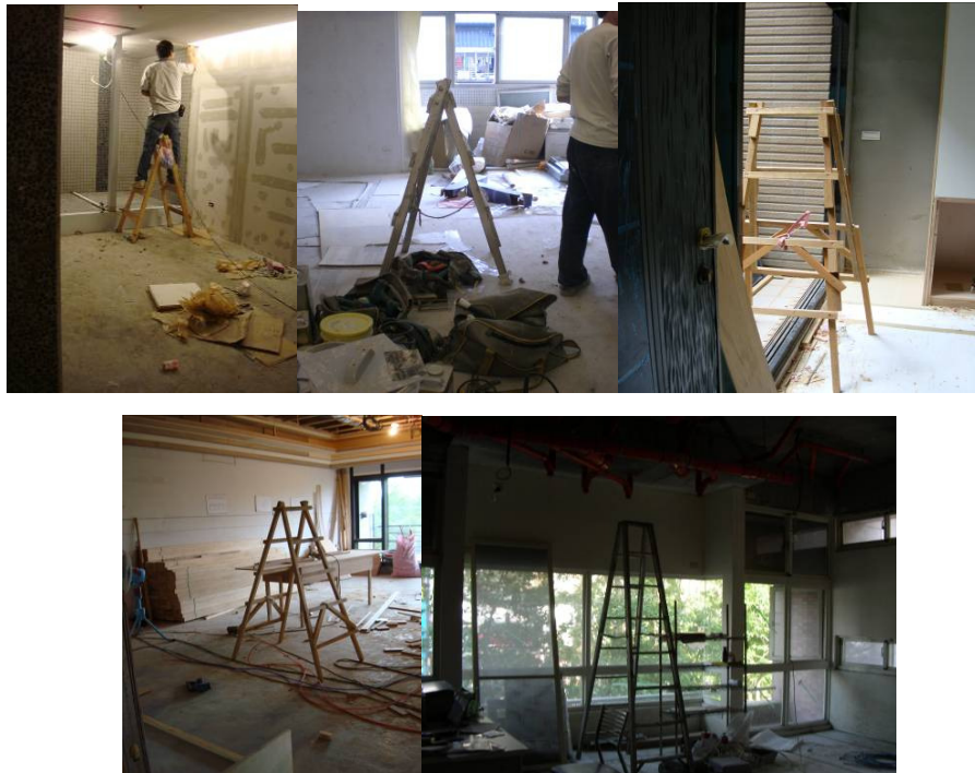
圖 3：勞工使用之合梯無安全踏面及固定繫材牢扣之錯誤態樣。
