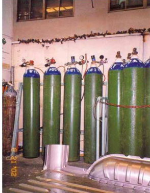
高壓氣體鋼瓶未依規定標明所裝氣體之品名且未妥予固定。
