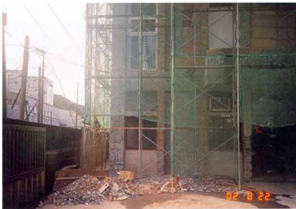
未設置滑槽及承受設備。
