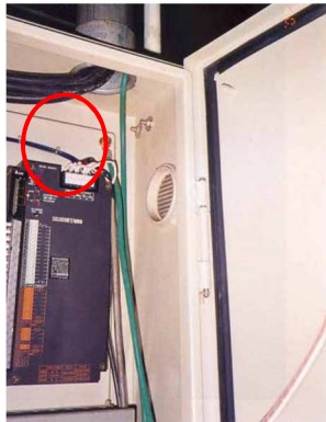
配電箱已設置接地設備
