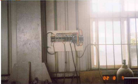
電氣開關未設置保護箱蓋。
