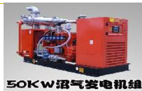
50KW沼氣發電機組
