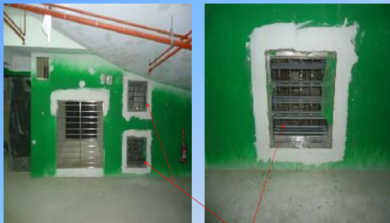
排風機前需設置 防火閘門
