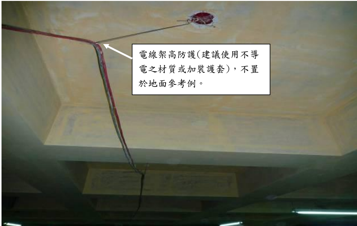
電線架高防護
