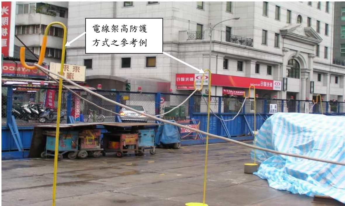
電線架高避免因地面積水導致電線浸水，受外力破壞絕緣而漏電。
