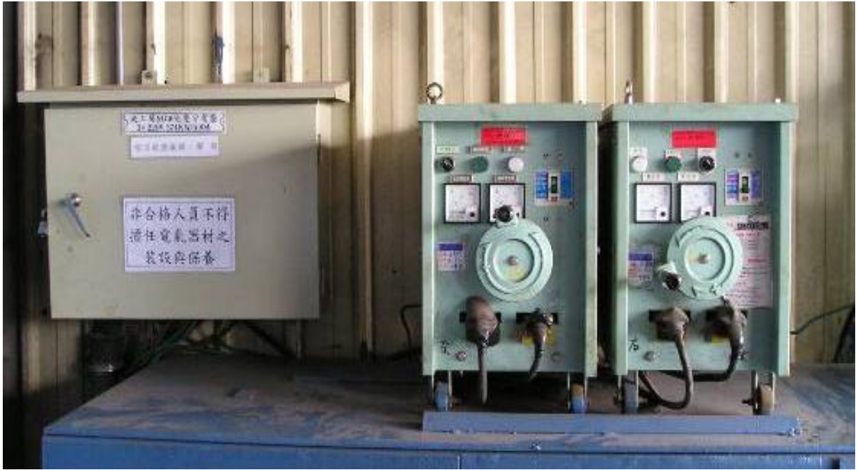
交流電焊機設置內藏式自動電擊防止裝置。 一次側設置漏電斷路器，二次側設置電壓表、電流指示表，二次側出線設置絕緣防護參考例。
