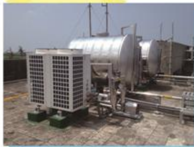
屋頂層空間放置設備及管線
