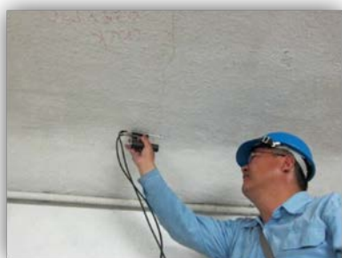
裂縫檢測(敦化基隆人行地下道)
