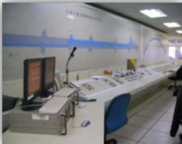
共同管道監控中心
