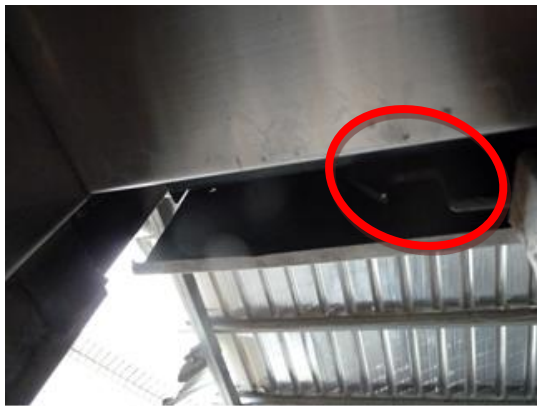
說明：升降機一樓乘場門連鎖裝置。
