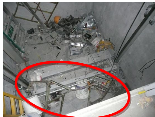
說明：工作平台護欄飛落至機坑。
