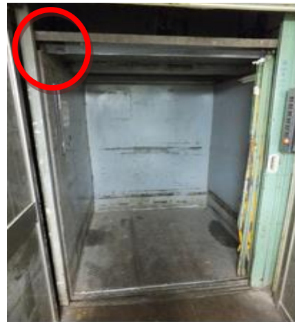
說明：升降機乘場門未裝設連鎖裝置(車廂不在該樓層，卻能打開乘場門)。
