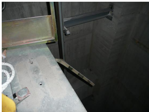
說明：伸縮拉桿挫曲彎折。
