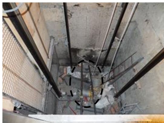
說明：地下三樓機坑，罹災者墜落處。
