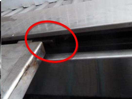
說明：升降機一樓乘場門連鎖裝置。
