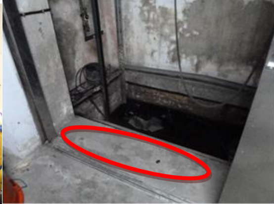
說明：勞工墜落於地下一樓機坑。
