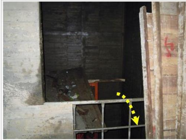
罹災者自19樓電梯直井內之遮斷板墜落至停在1樓的施工電梯車廂頂部（落距約63公尺）。
