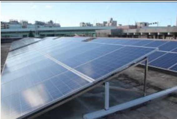
圖一：忠孝樓多晶矽太陽能板共計 47.52kWp
