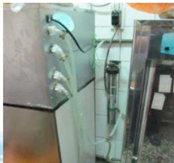
製冰機閥栓損壞持續進水並從排水管排出無法調控
