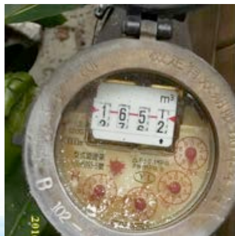
分表漏水用戶鎖門未 自報度數 實際度數 1652，抄表員依前期 用水量推定為1580
