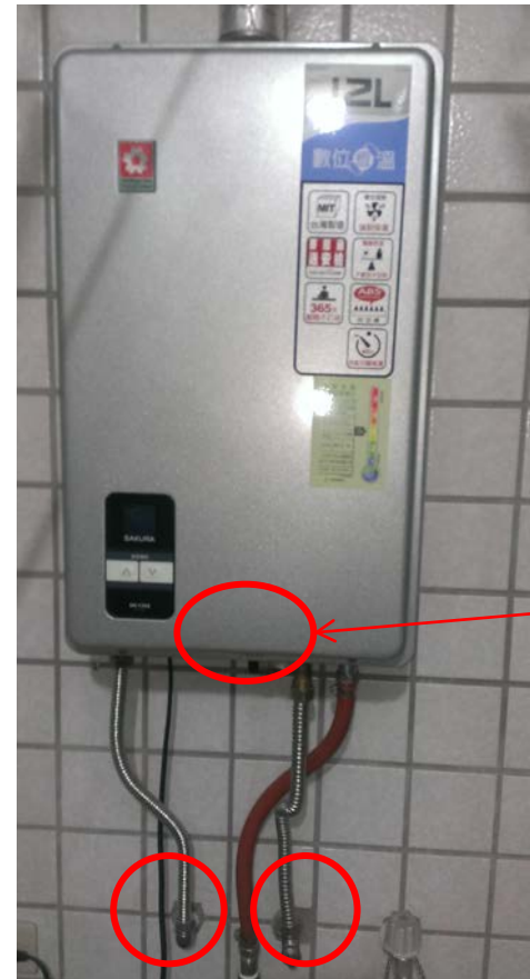
壁內管線漏水
