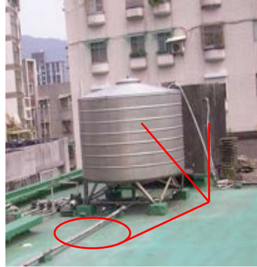
2棟水塔下方管線相通
