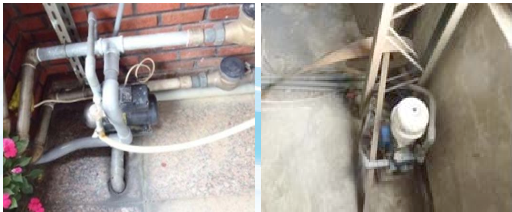
抽水機(馬達)損壞漏水、空轉
