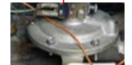
水盤橡皮破裂漏水
