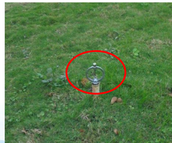
灑水器控制系統損壞無法調控
