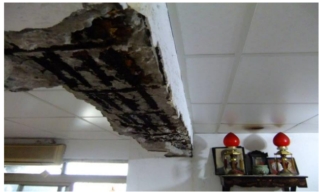
大龍國宅住戶屋頂受損情形(拆除前)
