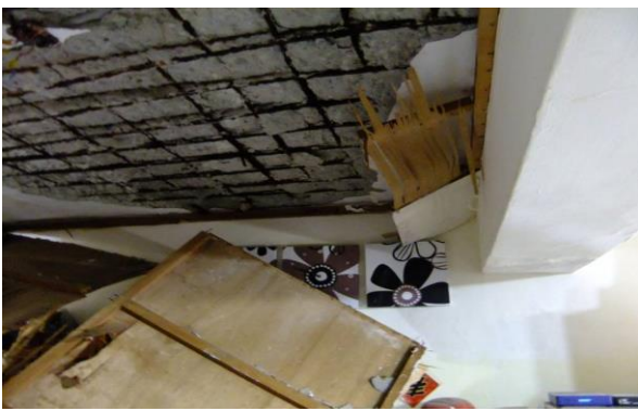
大龍國宅 12 樓住戶屋頂受損情形 (拆除前)
