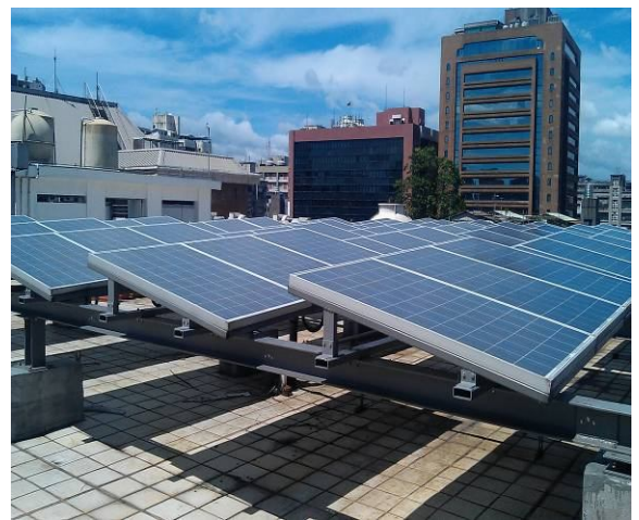
建國中學設置太陽光電發電系統
