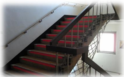
樓梯間不鏽鋼扶手(含安全網)
