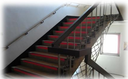
樓梯間不鏽鋼扶手(含安全網)
