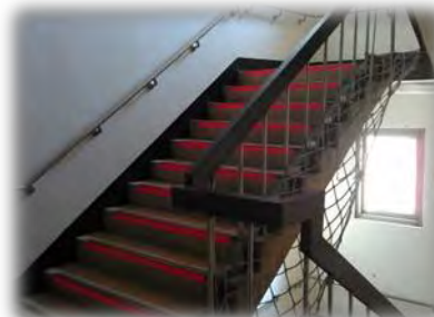
樓梯間不鏽鋼扶手 (含安全網)
