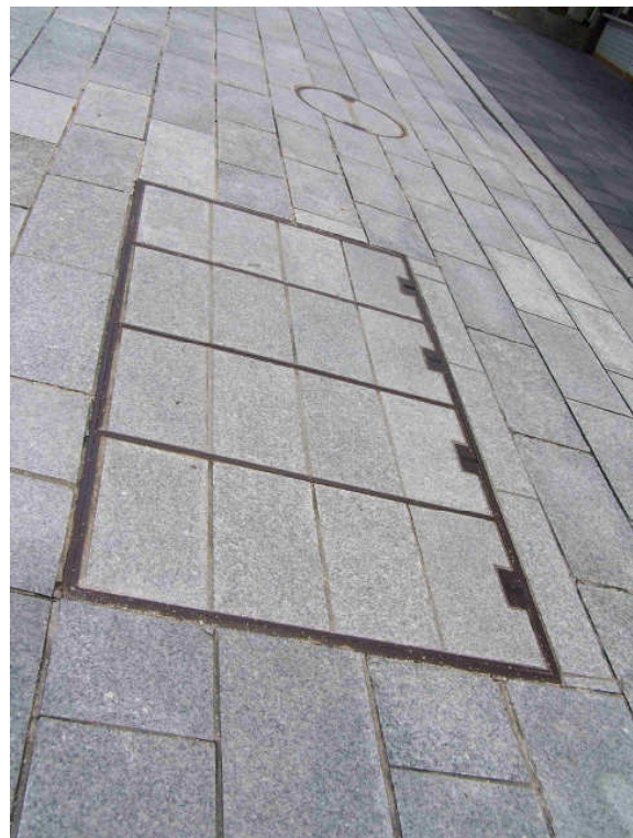
【圖 73 人孔蓋與路面平齊情形】
