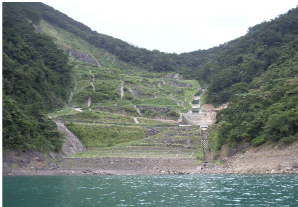
照片 3 97.6.30 國有林第四林班地崩坍整治
