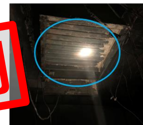
室內排煙設備
