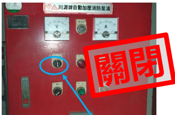
B2室內消防栓設備消防泵浦
