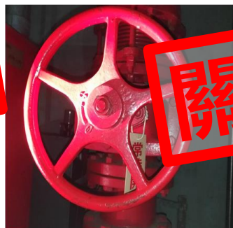
自動撒水設備主閘閥
