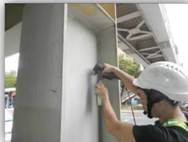
焊道磁粒檢測(師專附小人行陸橋)
