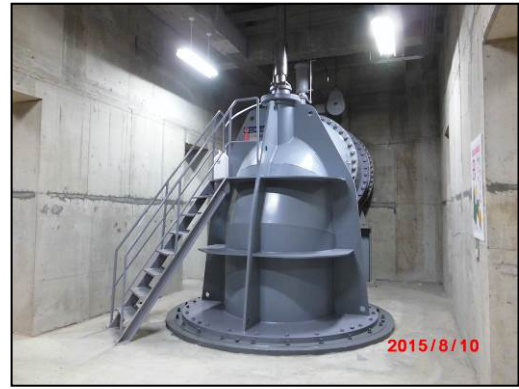
七號豎軸抽水機
