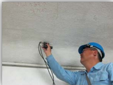
裂縫檢測(敦化基隆人行地下道)
