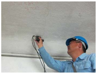
裂縫檢測(敦化基隆人行地下道)
