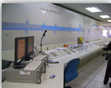
共同管道監控中心
