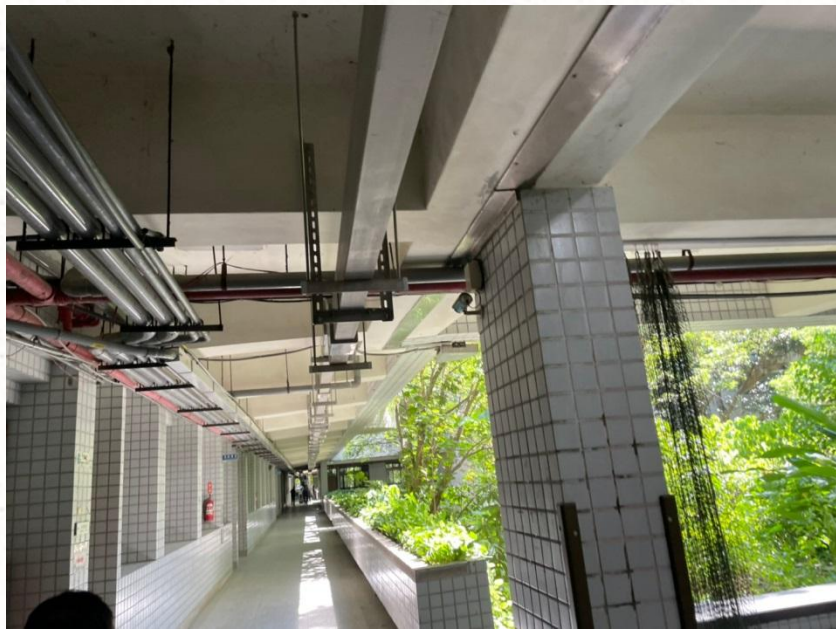
BusWay連接至各分電盤
