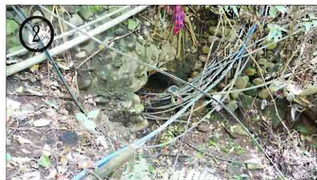
中興路下銜接上游溪溝之涵管
