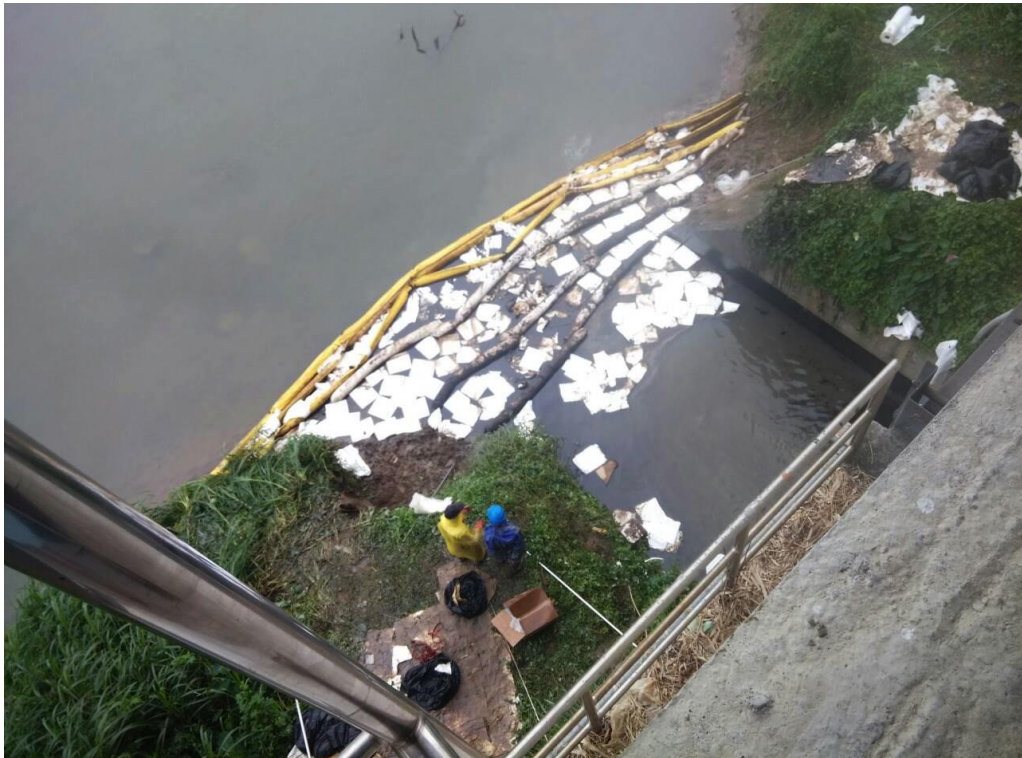
圖 2 新北市草濫溪抽水站外攔油索設置情形
