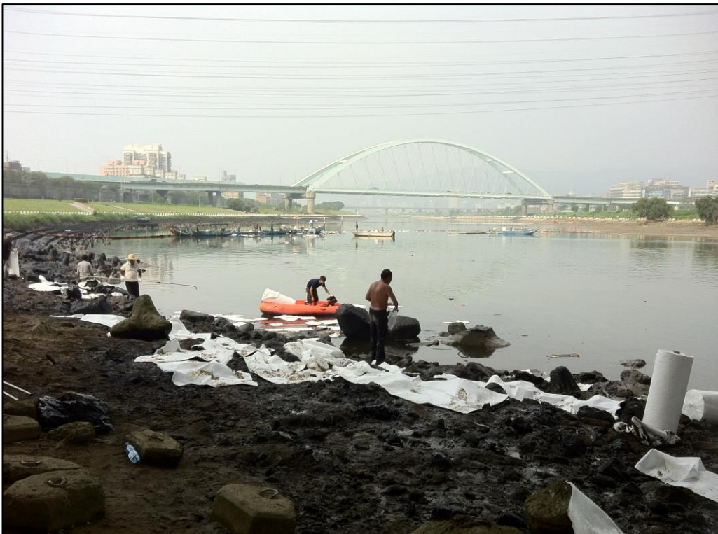
圖 9 麥帥一橋下除污作業情形
