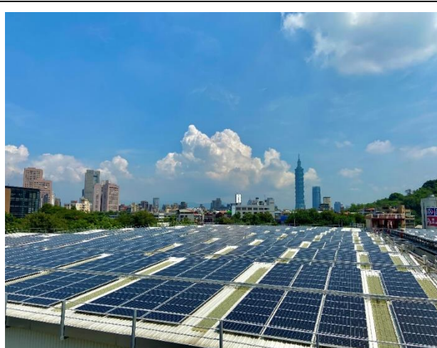
長興淨水廠設置太陽光電
