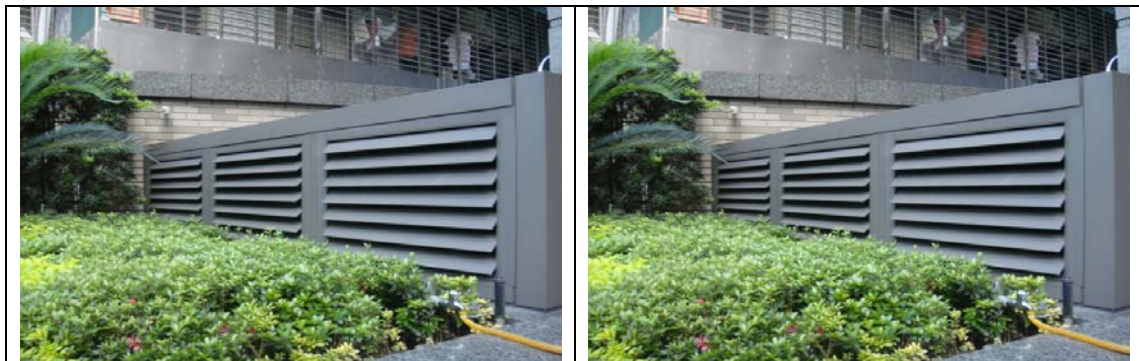
立面式通風排氣設施綠美化示意照片
